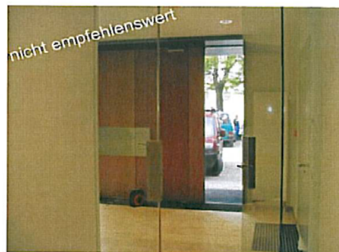
Bild 9 Schwer erkennbare Glastüren (Tür im Windfang eines Mehrfamilienhauses)
